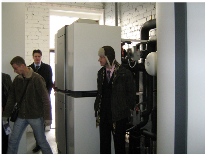
Два блока тепловых насосов с мощностью производства тепла 70 кВтч каждый, которые установлены в средней школе города Скаисткалне
