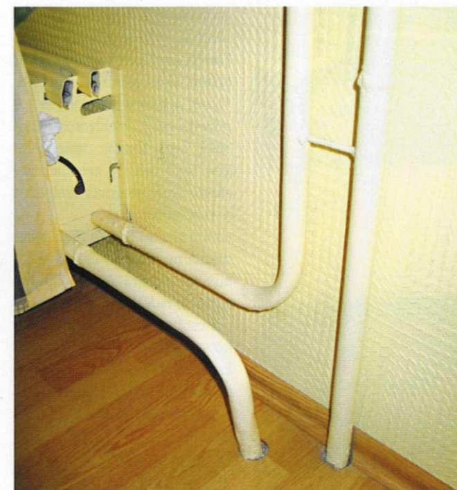
1. attēls. Oriģinālais sildķermeņa pieslēgums dzīvoklī.
