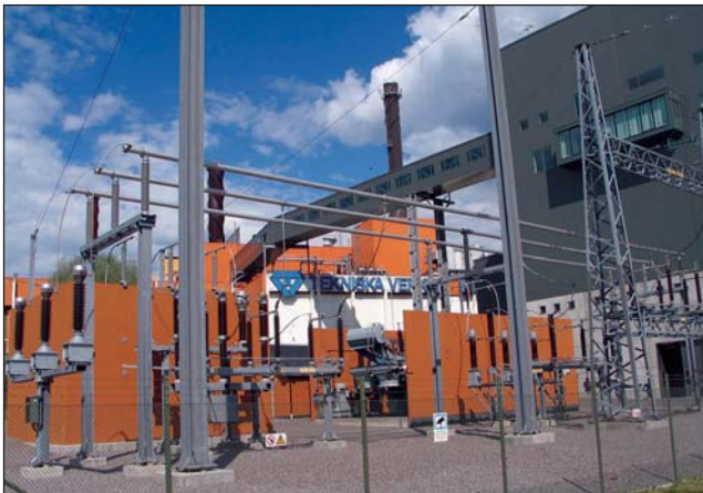
2. attēls. Gerstadas atkritumu dedzināšanas TEC augstsprieguma apakšstacija
