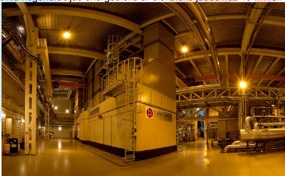
Attēls 10. SC „Imanta” koģenerācijas energobloks
