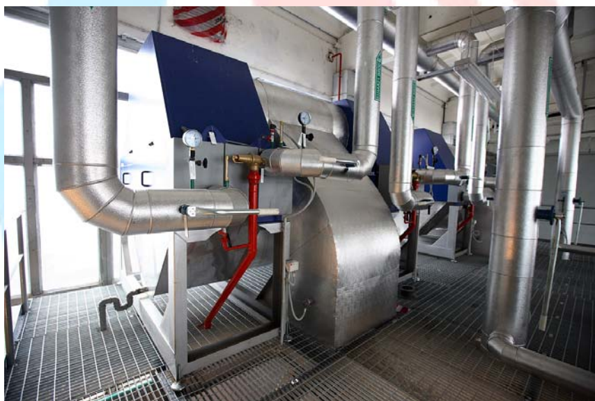
Attēls 4. KM Trijādības ielā 5 kondensācijas ekonomāizeri TOTALCO T42
