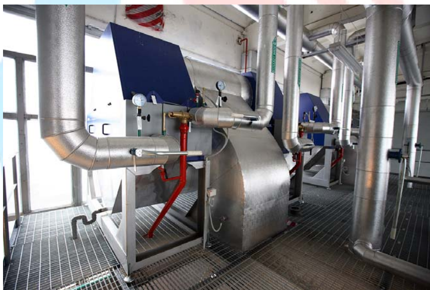
Attēls 4. KM Trijādības ielā 5 kondensācijas ekonomaizeri TOTALECO T42
