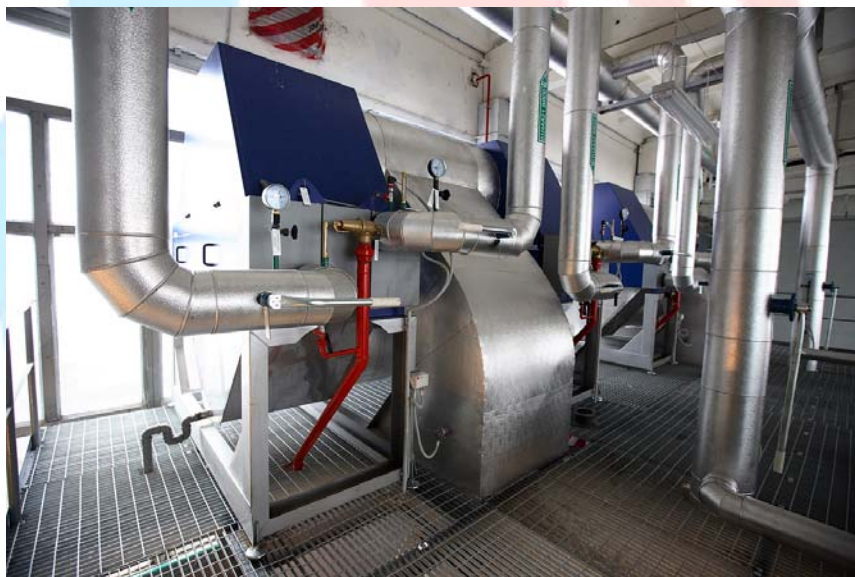
Attēls 4. KM Trijādības ielā 5 kondensācijas ekonomizeri TOTALECO T42
